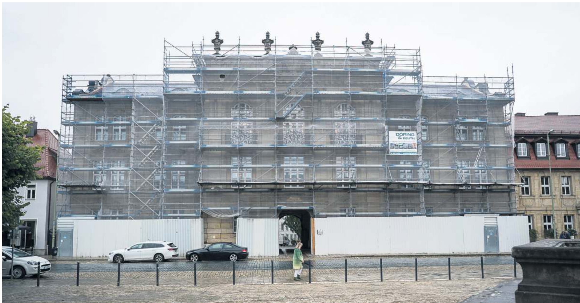
Die verpackte Regierung: Nach eineinhalb Jahren kommt das Gerüst nächste Woche wieder weg. Das Gebäude wird wieder strahlen in der Ludwigstraße.
