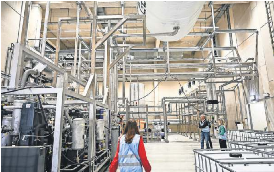
Eines der Herzstücke der Brauerei – die Energiezentrale, in der unter anderem die Kohlensäure-Rückgewinnung steht (links).
