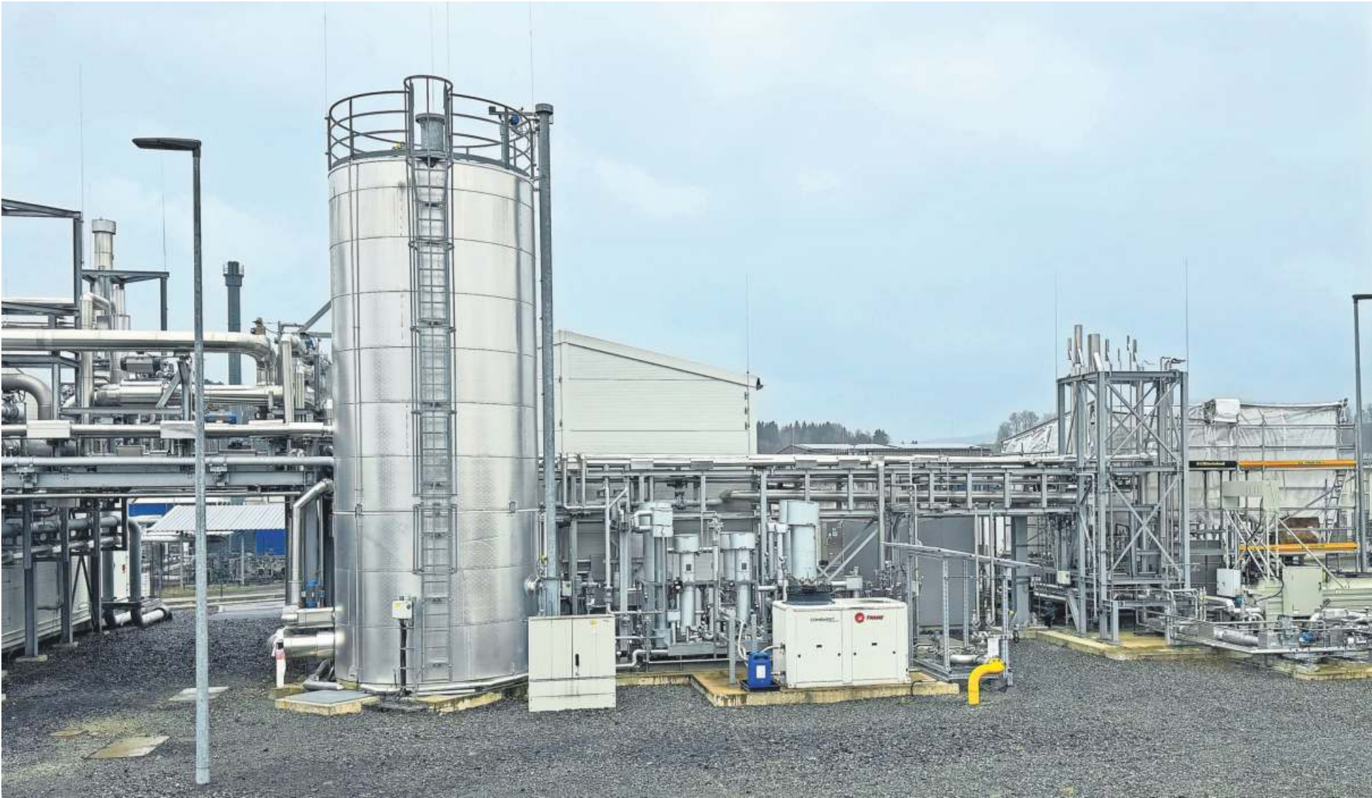
Der Energiepark Hochfranken wird kein klassischer Industriepark wie der in Wunsiedel.
