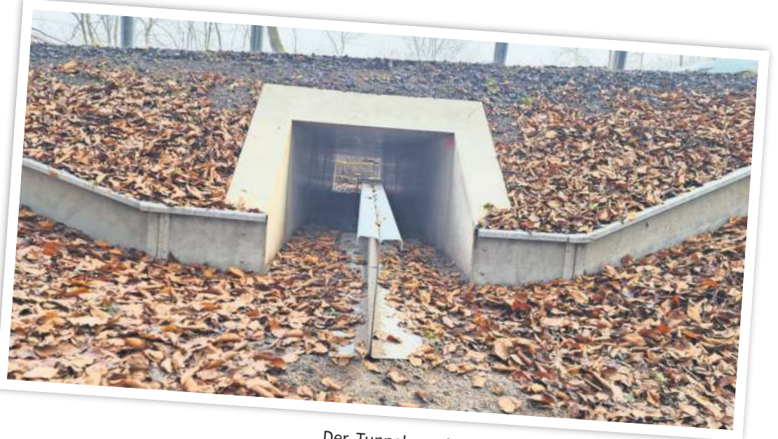
Der Tunnel an der festen Amphibienschutzanlage bei Burgstall.
