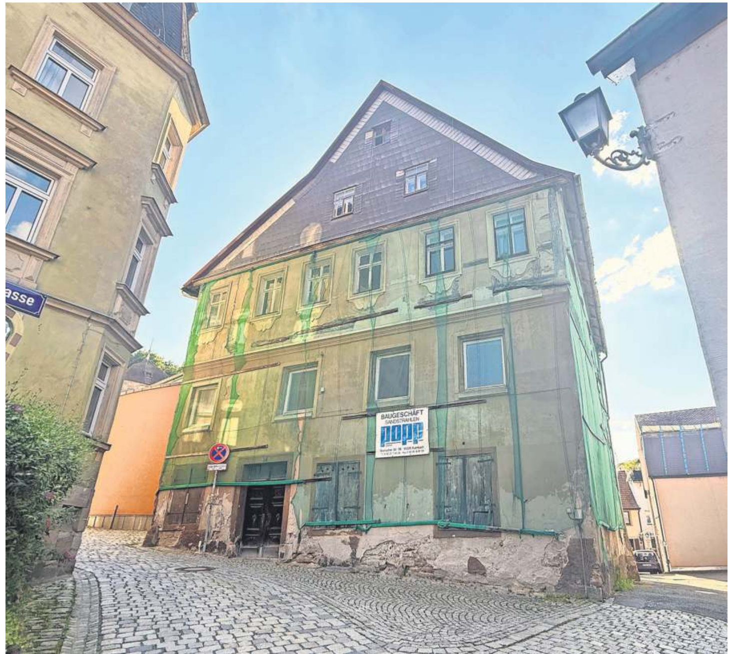
Das Gebäude in der Waaggasse 2 verfällt seit Jahren. Doch eine Sanierung auf städtische Kosten gilt als riskant.
