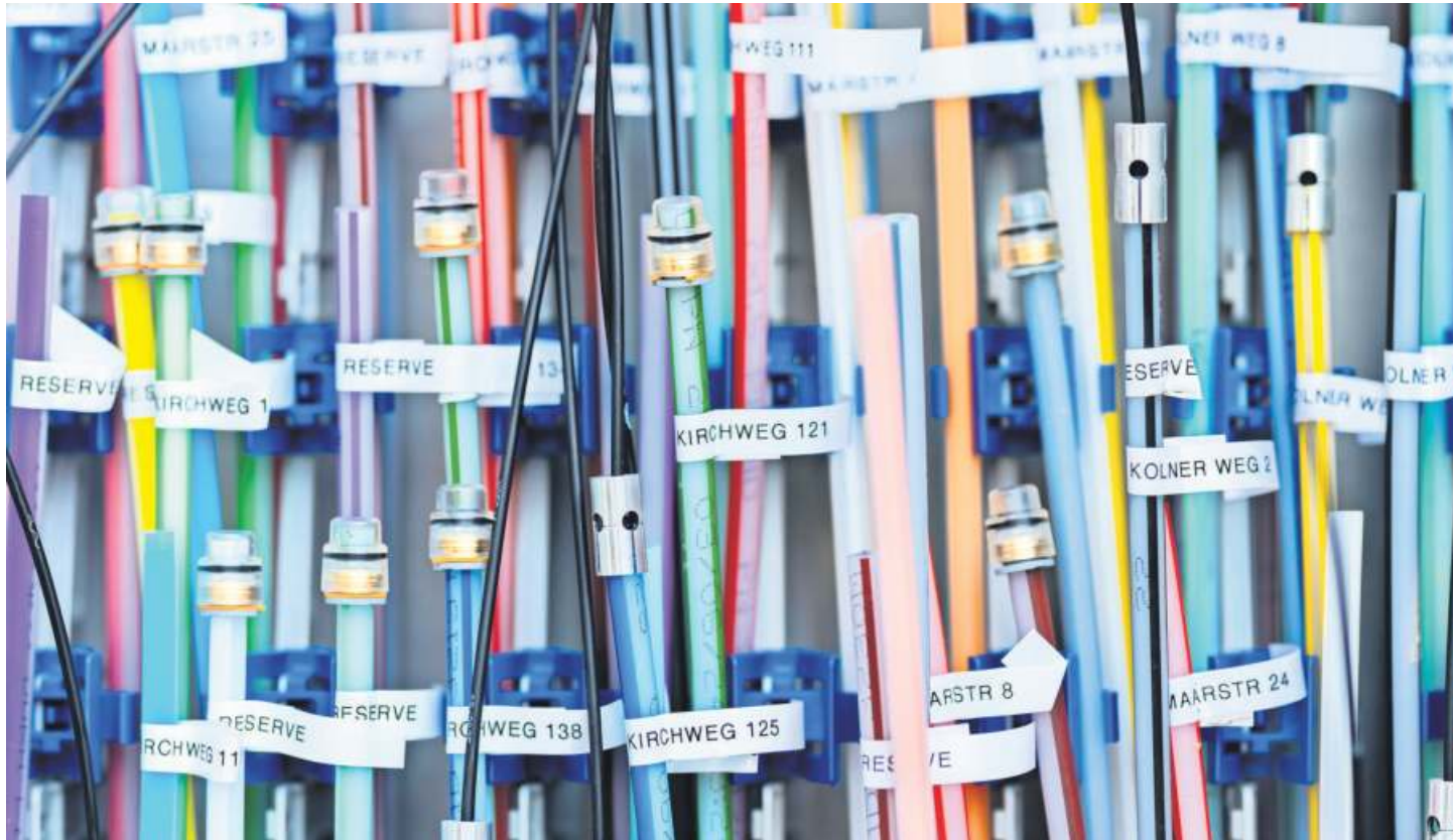
Glasfaser-Kabel in einem Verteilerkasten.
