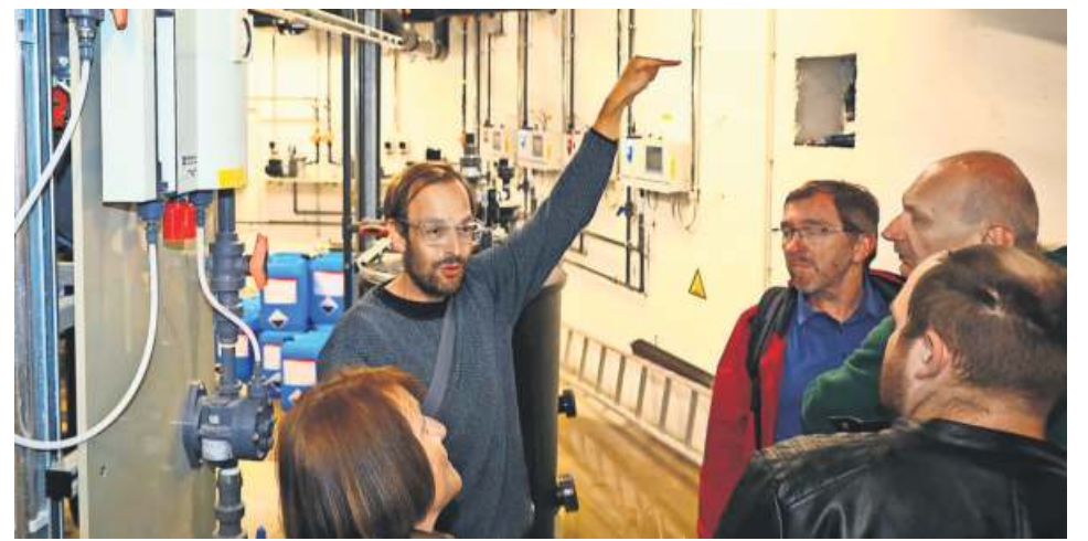
Leitungen, Rohre, Behälter: Architekt Jörg Albrecht erläuterte die komplizierte Technik.
